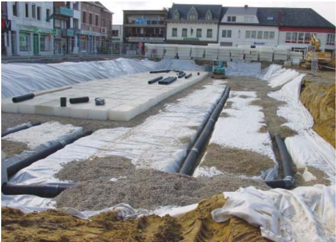
Bassin de rétention souterrain pour l'infiltration d'eau de pluie; commune de Haacht.
