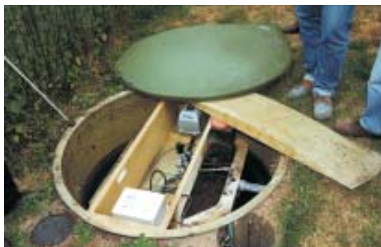
Lit bactérien aérobie (voir A.2. p. 68)
